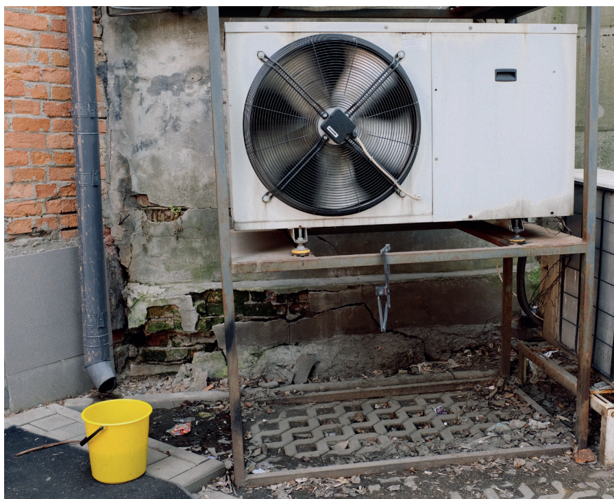
Système de chauffage par ventilation
