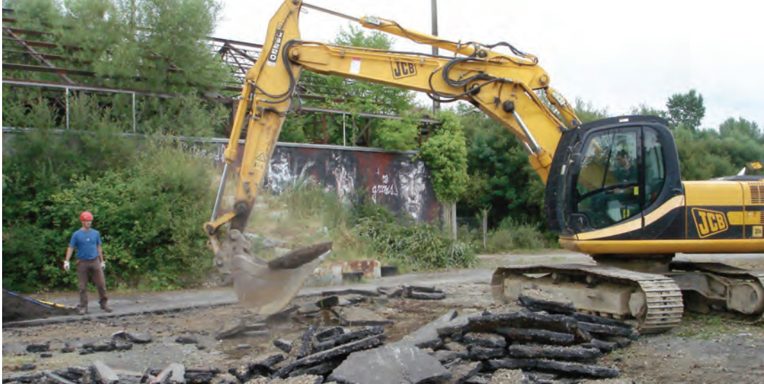
Décroulage de la dalle de bitume, Le Transformateur
